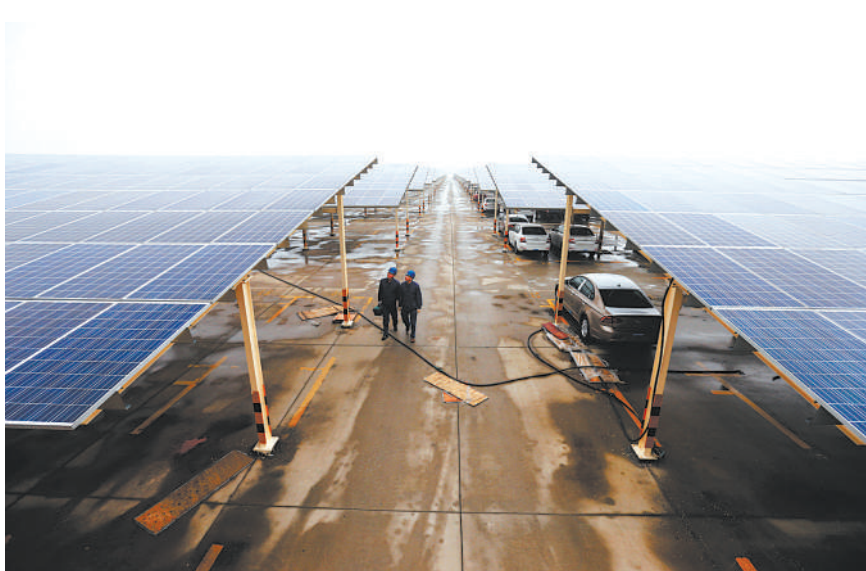
工作人员正在对屋顶光伏电站进行投产验收
