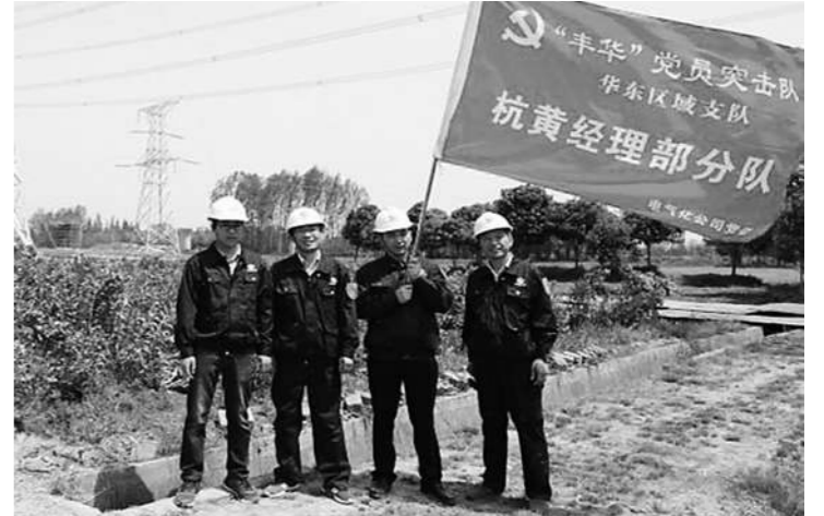
日前,商合杭高铁浙江段进展顺利,拆除了±800kV直流特高压输电线路,为商合杭高铁建设拆除了最大“拦路虎”。商合杭高铁浙江段35kV及以上高压迁改工程由中铁四局电气化公司承建。本次迁改的±800kV直流特高压输电线路由四川屏屏至江苏同里,拆迁长度2200米,也是目前国内电压等级最高的直流输电线路。通讯员张建哲、杨贤仁 摄
