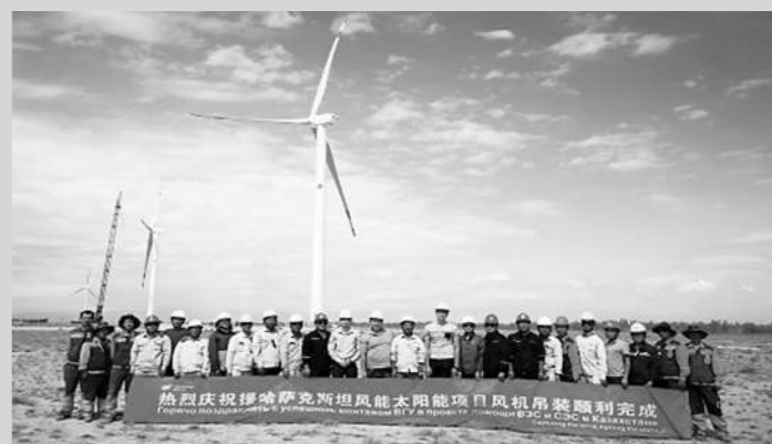
“浙江安装”援哈萨克斯坦风能太阳能项目风机吊装顺利完成
