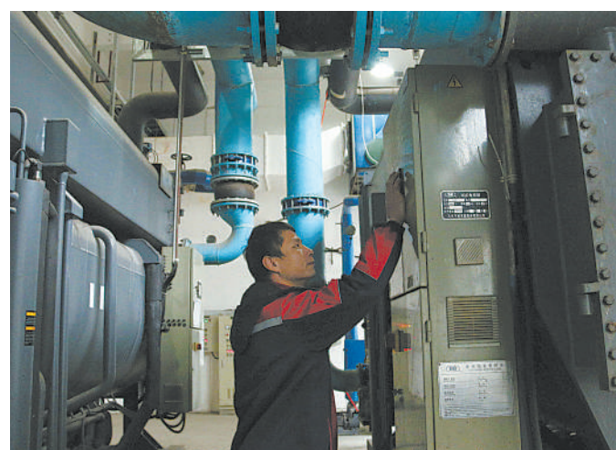
“激智科技”工程部经理顾颖瑶在检查设备,为开工做准备。
