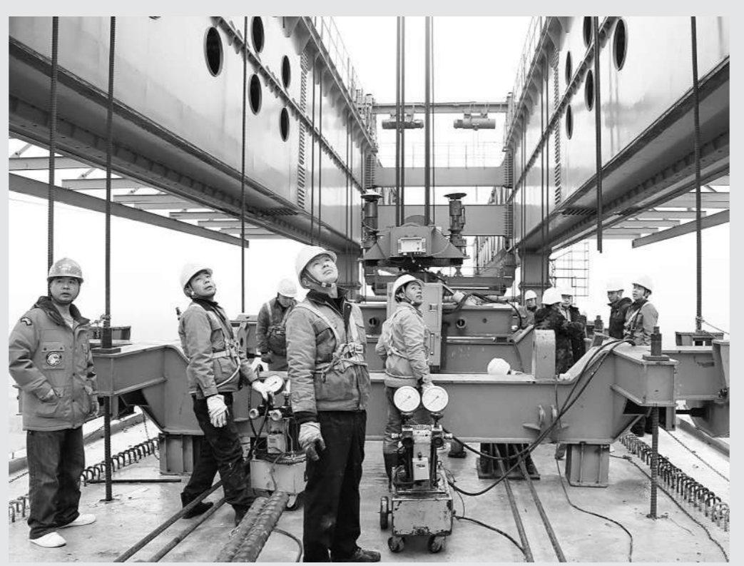
近日,省交通集团投资建设的金台铁路工程——仙居县田市跨永安溪特大桥梁正在施工,大桥共60孔,全长跨度为56m,是浙江省、乃至华东地区迄今最大跨度的铁路工程,堪称华东地区“跨度之最”。
