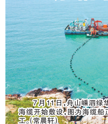
7月11日,舟山嵊泗绿华岛至花鸟岛10千伏第三回路海缆开始敷设,图为海缆船正在开展绿华岛端海缆登陆施工。(晨晨轩)
