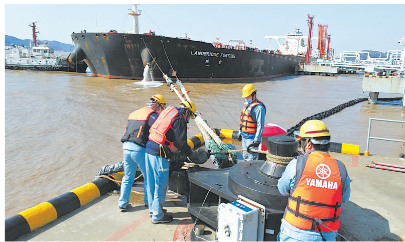
昨日上午10时，30万吨级油轮“LANDBRIDGE FORTUNE(瑞丰)”号装载28.7万吨原油，顺利靠泊全国最大石油转运基地——中化兴中石油转运(舟山)有限公司岱山基地。
