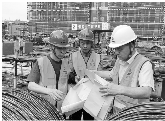
吴高利(右)和工友们讨论钢筋的受力支点等问题。 记者潘仙德 摄
